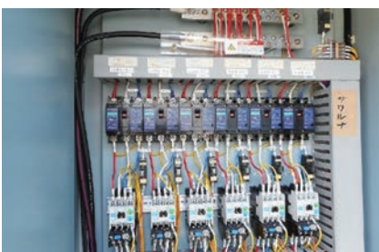
GOODポイント1 間違いがないよう配電盤内の表示を見やすく整備
